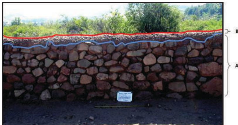
Figura 49. Pasillo, Muro 1. Detalle Capa A y Capa B. Fuente: Elaboración propia.
